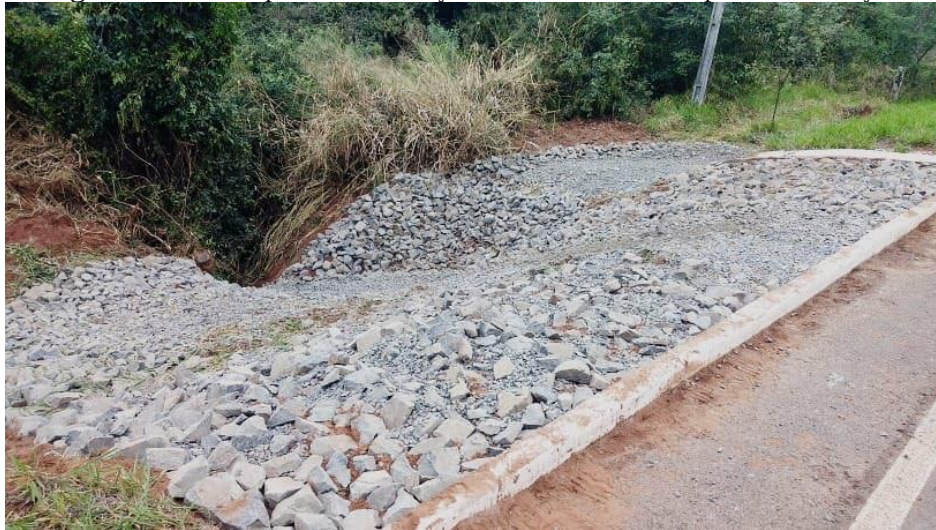
Figura 27– Exemplo de utilização de enrocamento para contenção
